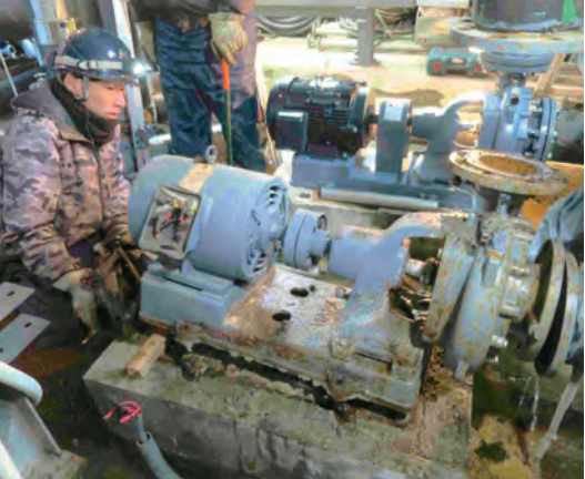
▲青木井戸濾過ポンプ交換 ＜ 抵抗値調査により異常が見られたポンプは優先的に計画更新します＞
