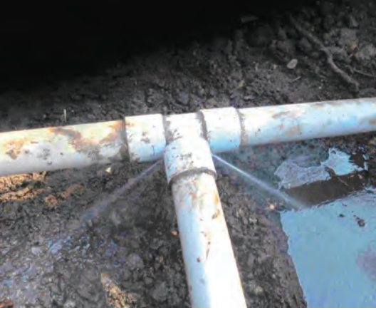
▲玉取平漏水修理 ＜つなぎ目の亀裂からの漏水です＞
