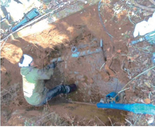
▲緑の郷漏水修理 ＜大規模な漏水になりました＞
