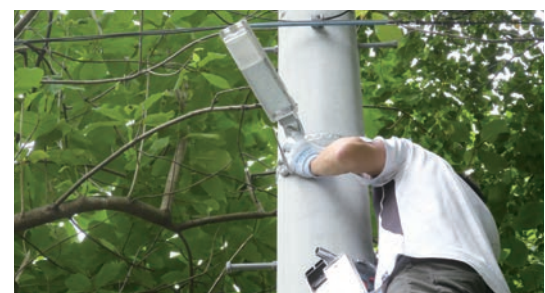
⑧青木LED街路灯への交換： 蛍光灯器具の破損時には順次LEDに交換しています。基本は電柱直付です。
