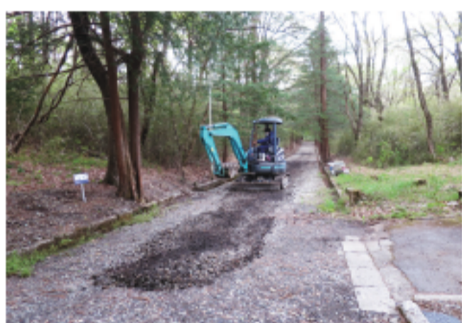
年度計画に基づき玉取平の道路補修を行いました。法人化により、水道施設や道路の名義の問題も解決していきます
