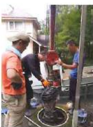
配水ポンプ交換 ●秋風苑 老朽ポンプの故障発生。予備ポンプの在庫があるので給水に影響はなし。今後は数種類のポンプの在庫が必要でしょう。
