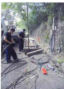
神明平の井戸ポンプ故障は落雷が原因かと。お盆前の緊急対応でした。
